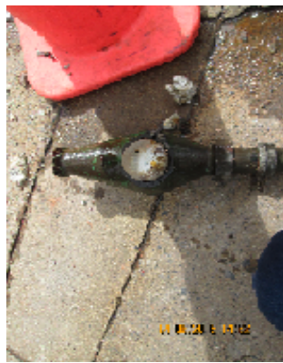
Foto No. 4. Vista general del medidor, desinstalado.
